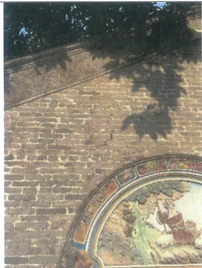
两侧山墙墙体开裂
