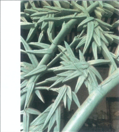
碧溪草堂圆光罩局部风化开裂褪色
