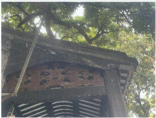
碧溪草堂木梁架局部风化开裂。糟朽
