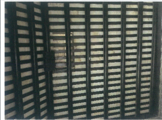
碧溪草堂屋面风化
